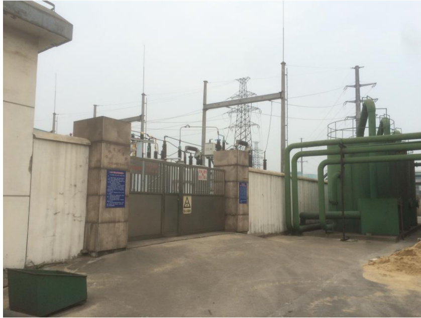
图 1-2 变电站现状图
